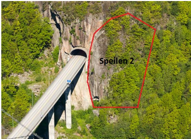
Figur 2-40: Påhuggsområde sørøst for tunnel i korridor A1 og A2 med tunnelmunningen til eksisterende Fedaheitunnelen og viadukten til Fedafjorden bru. Antatt avgrensning av, et avløst bergparti (Speilen 2) med vertikal baksprekk og undersprekk med fall ut mot fjorden, er markert. Tunnelpåhugg for tunnel ny E39 kan komme så nær Speilen 2 at tiltak må gjøres med bergpartiet.
