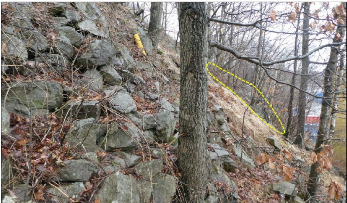
Figur 35: Løsmasseskråning – flere blokker stabiliseres av treet på midten av bildet. Figur hentet fra rapport levert av Norconsult.
