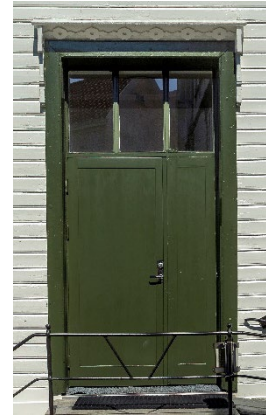
Nygaten 7 – Feil dørtype er satt inn
