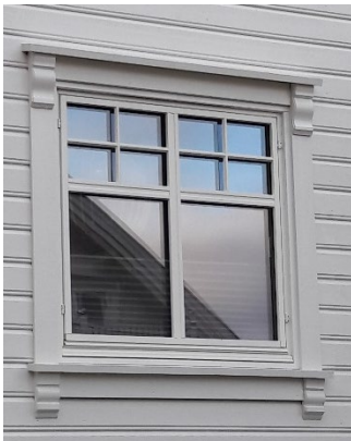
Løse utenpåliggende sprosser – Uheldig løsning som skal unngås i vernesonen
