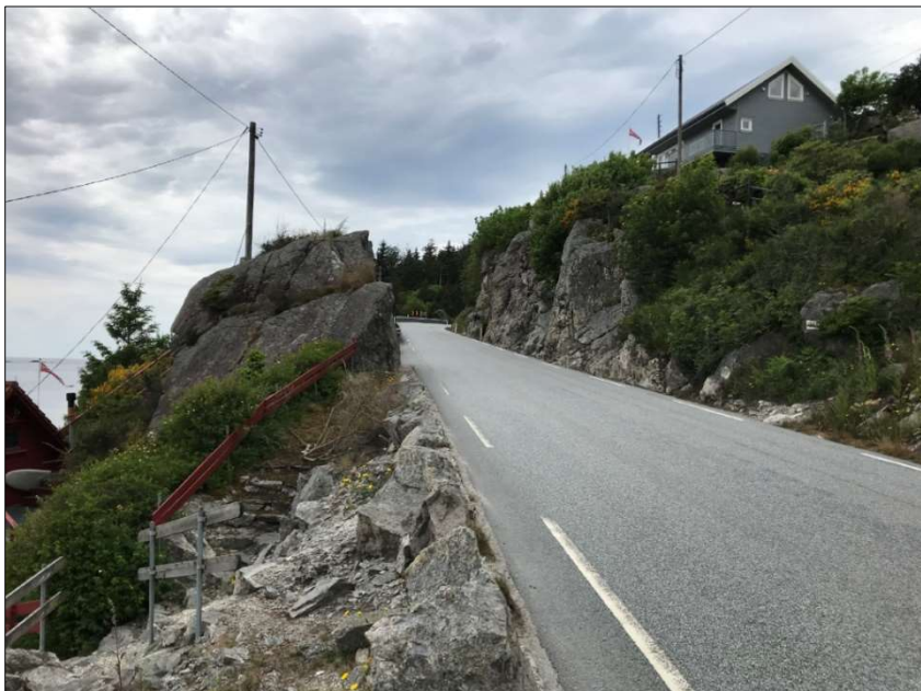
Figur 6: Bildet er tatt ved Sandarnes som ligger i delstrekning 1. Vegen her er smal med dårlig sikt og uten rekkverk. Det er lite spillerom mellom hytten på oppsiden og naust på nedsiden av vegen.
