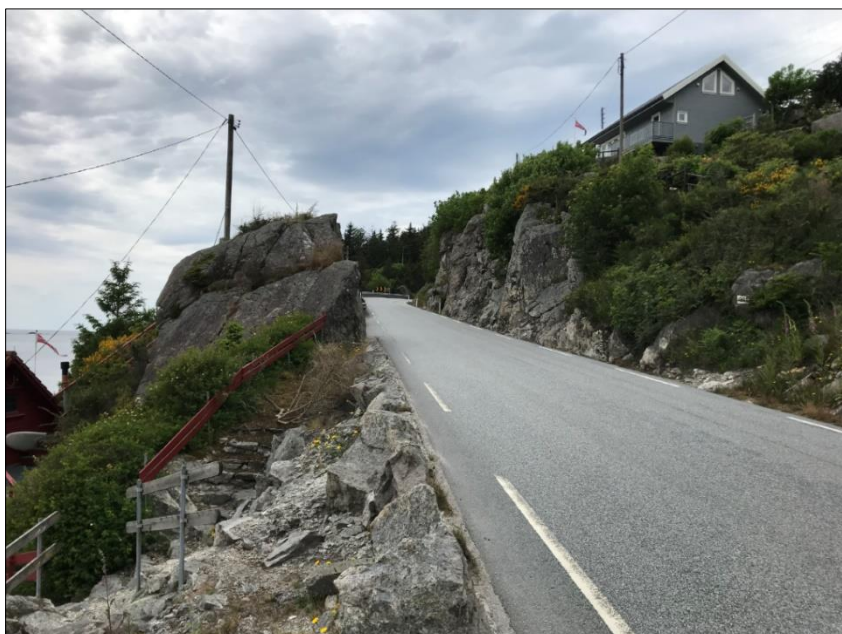
Figur 6: Bildet er tatt ved Sandarnes som ligger i delstrekning 1. Vegen her er smal med dårlig sikt og uten rekkverk. Det er lite spillerom mellom hytten på oppsiden og naust på nedsiden av vegen.
