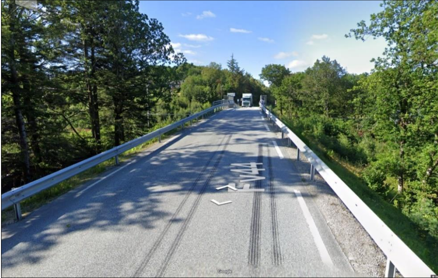
Figur 7: Brua som går over jernbanen. Vegen er smal og sikten dårlig, og frihøyden under brua er for lav.
