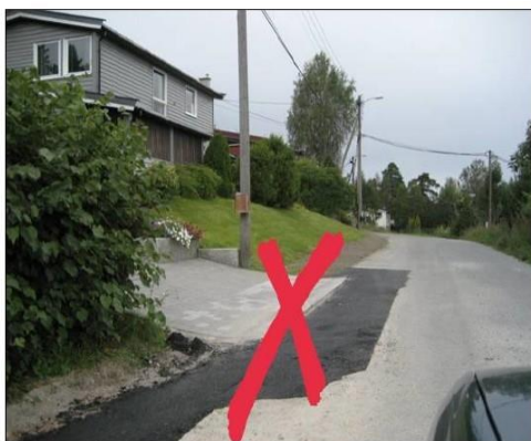
Uønsket endring av grøftetrasé
