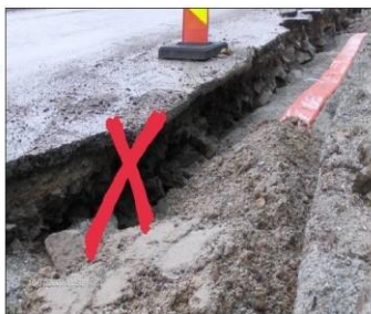
Utrasing av grøfteside. Her må det foretas skjæring av asfalt og justering av grøfteskråning
