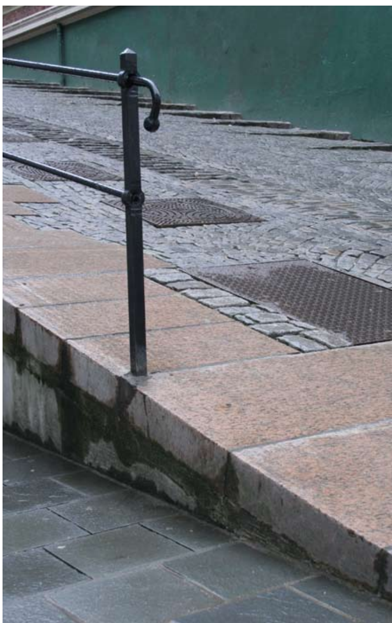
Et rekkverk må ikke stoppe før man er på trygg grunn.
