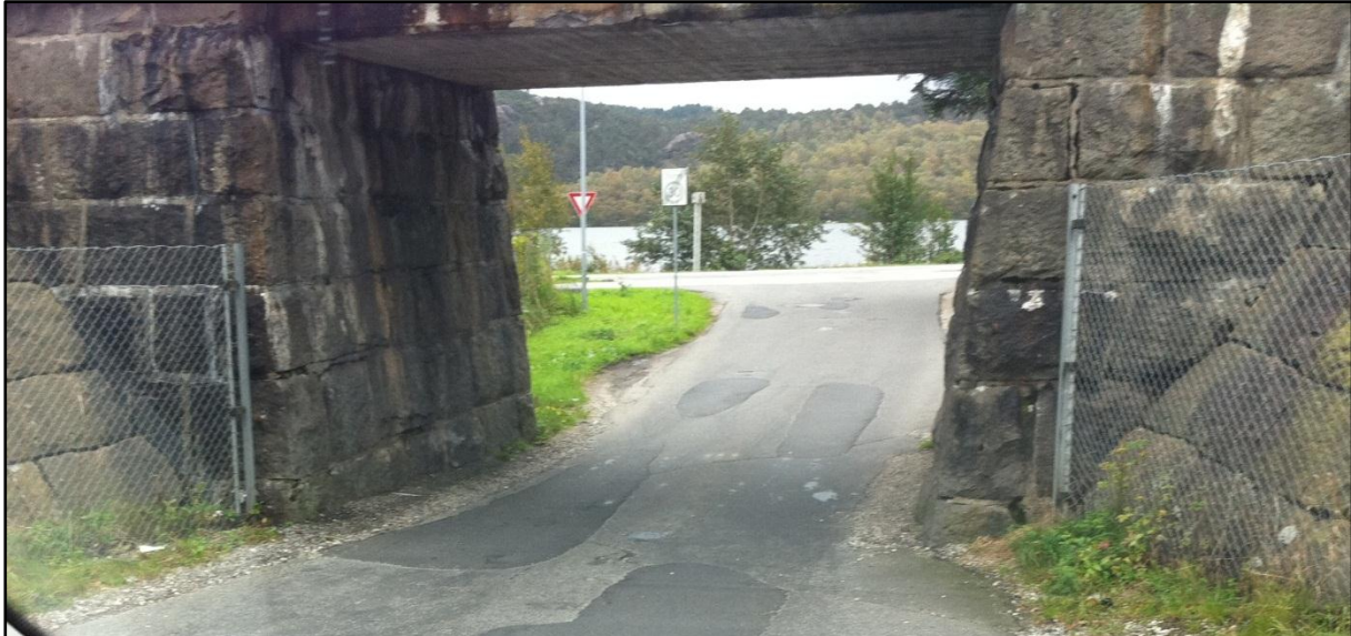
Figur 11. Lagårdsveien tilknytning til RV 42, er smal, har dårlig sikt.
