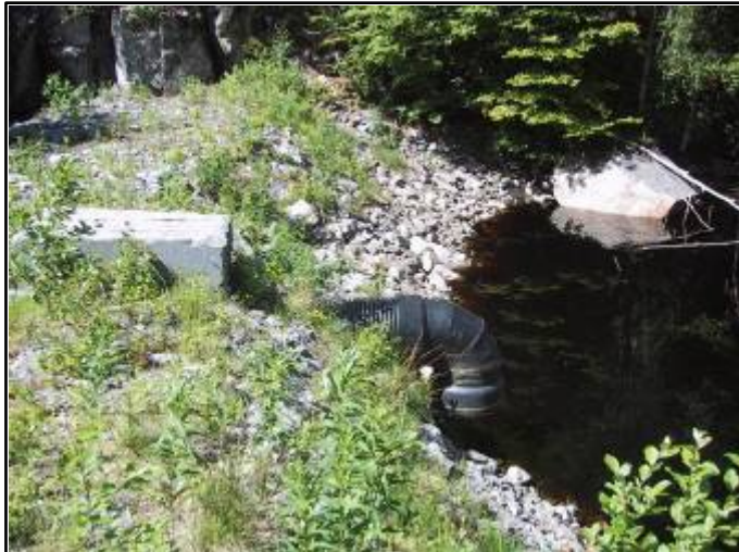
Figur 82. Dam med dukkert som hindrer spredning av olje ved eventuelle lekkasjer.
